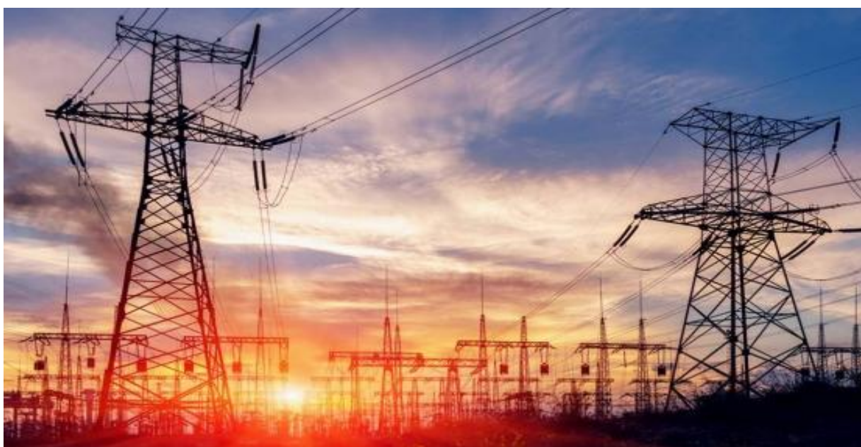
ЛЭП и трансформаторы на электrorаспределительной подстанции. (Фото: Yelantsevv/Freepik.com)
